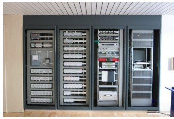
Der Serverraum befindet sich im Keller des Techhome
